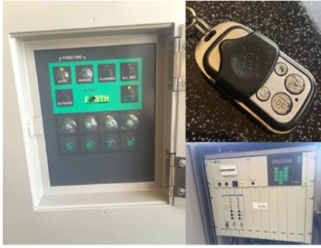
รูปที่ 3 ตู้อุปกรณ์ควบคุมจราจรจำนวนและรีโมทควบคุมสัญญาณไฟจราจร
